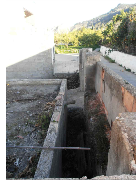
EDIFICACIÓN SEPARADA DEL MURO POR EL HUECO DE UNA ACEQUIA EXISTENTE
